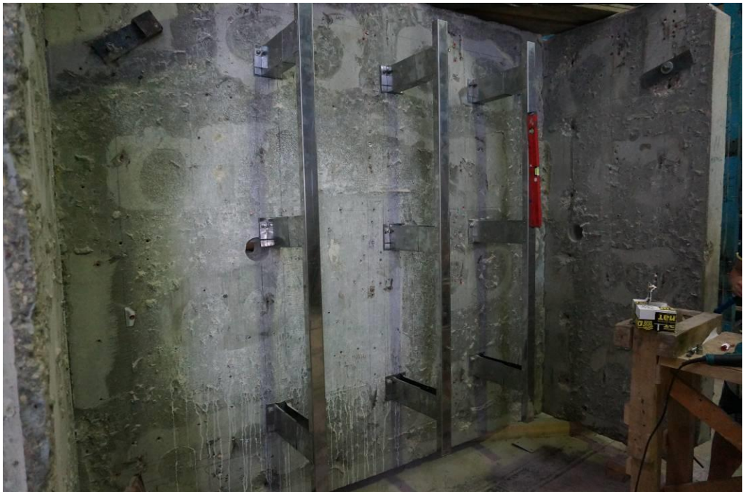
Рис. 4.1 Общий вид железобетонного стенда с закрепленными на нем несущими элементами фасадной системы.
